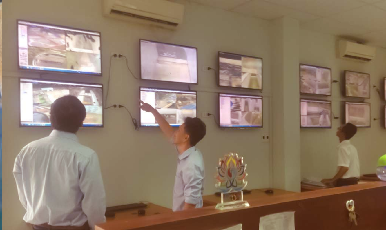
Trạm điều hành Trung tâm hệ thống Quan trắc tự động
